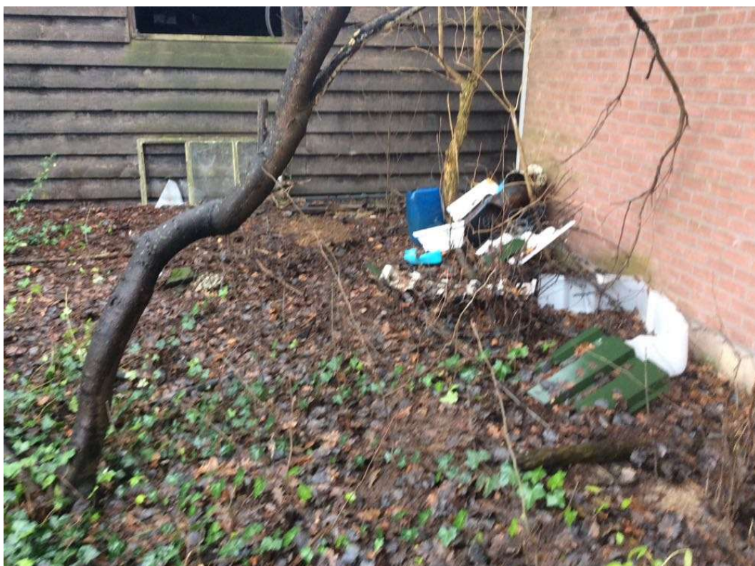
Asbestverdacht materiaal en olieopslag (B1) bij noordzijde werktuigenberging.
