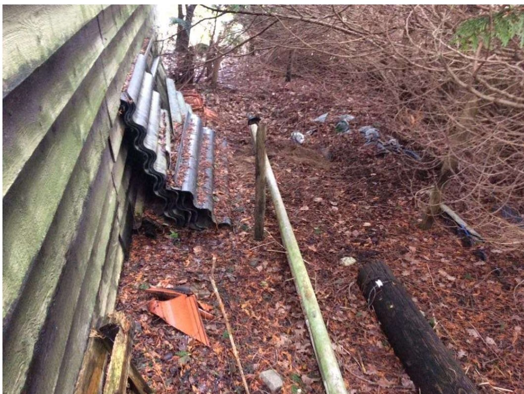
Asbestverdacht materiaal bij zuidzijde werktuigenberging, in oostelijke richting.
