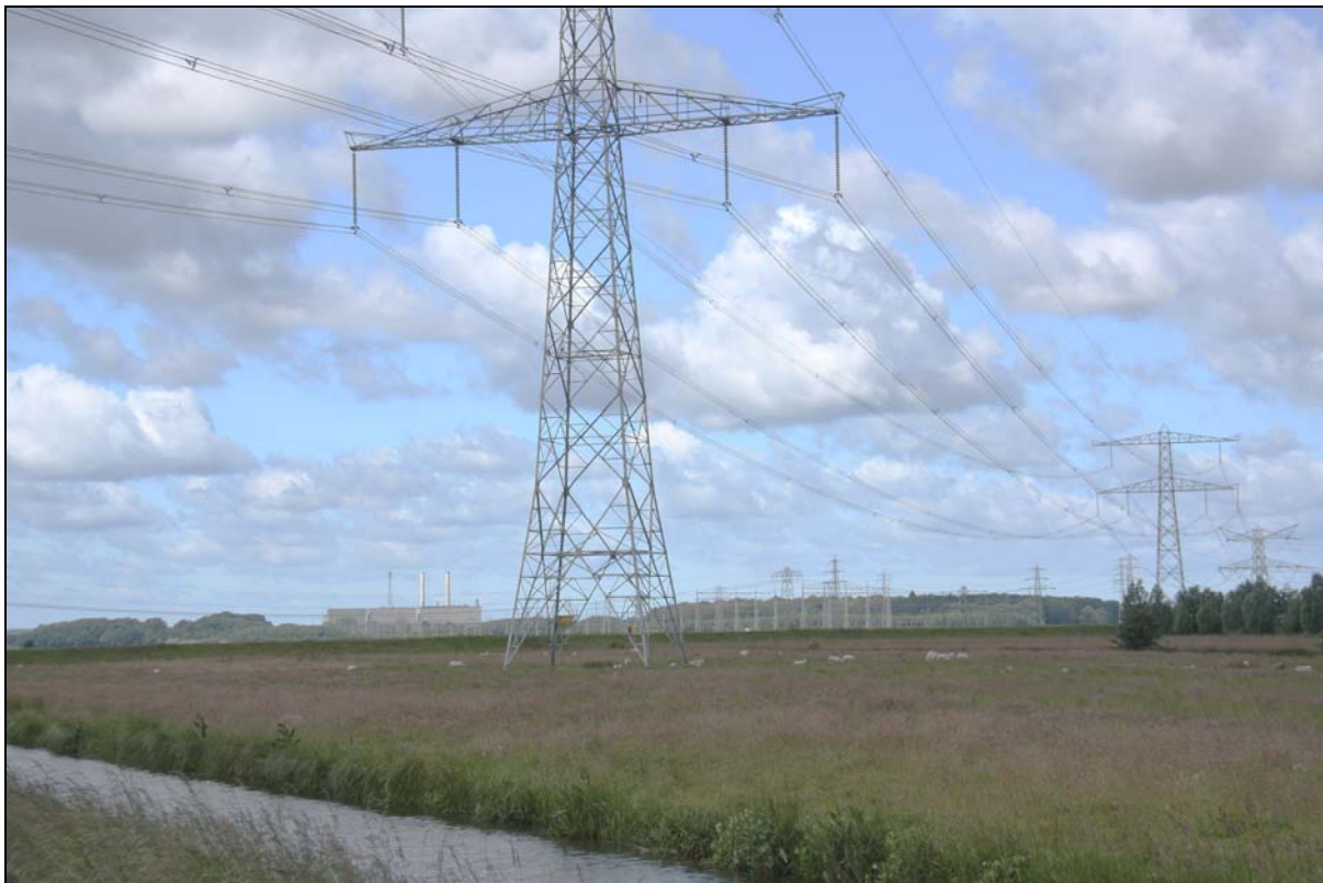
De IJsselcentrale bij Harculo met de hoogspanningsleidingen in de Polder Sekdoorn.
