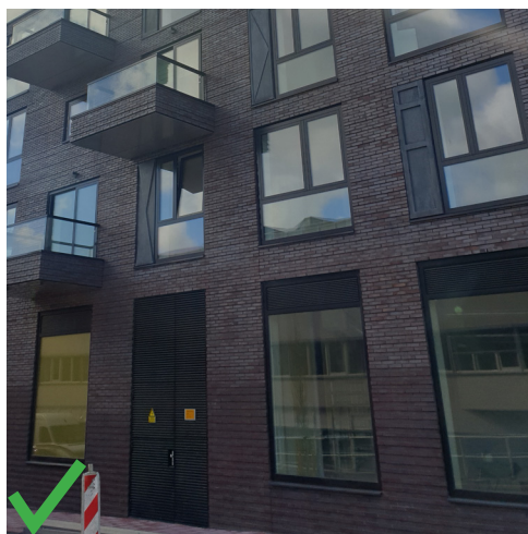
Technische ruimte / transformator geïntegreerd in de materialisatie van de gevel
