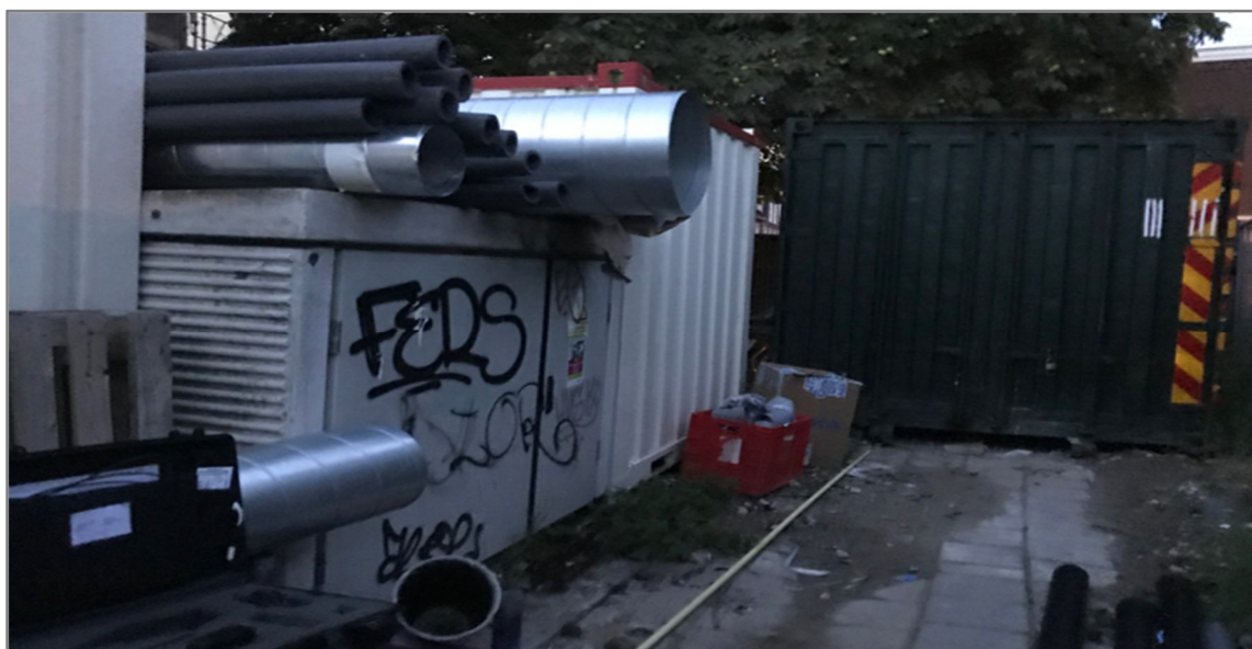
Figuur 2.3 Transformatorkast Hoogstraat te Zwolle
