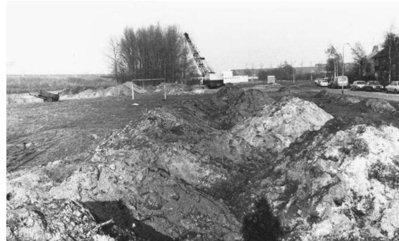
Afb. 63 Werkzaamheden aan het Prins Clauspark in februari 1977. Rechts de Prins Bernhardstraat (foto coll. HCO FD0HCO001000149).
