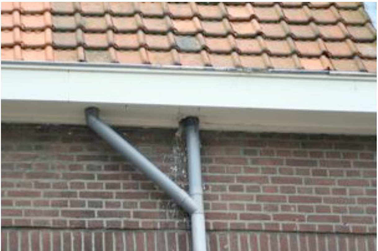
Afbeelding 5: Ruimte rondom de afvoer wordt door vogels gebruikt om toegang te krijgen tot het boeibord
