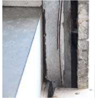
Foto 6. Onderzijde gevelbekleding met spleet.
