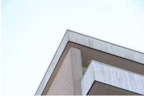
Foto 5. Daklijst van marmer, aan de onderzijde afgewerkt met plaatmateriaal.
