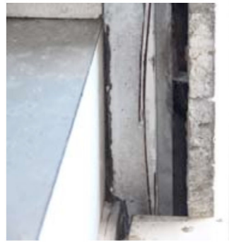
Foto 6. Onderzijde gevelbekleding met spleet.
