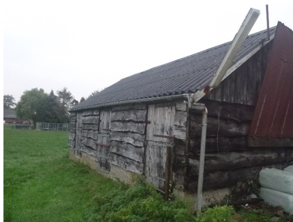
Dakgoot westelijk schuurtje westzijde Rondweg
