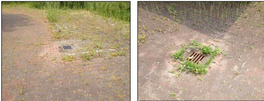
Figuur 13 Kolken ten behoeve afwatering verhard oppervlak
