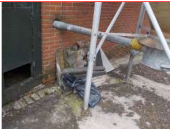
Foto 7 | Foto voor bron Losliggende restanten golfplaat
