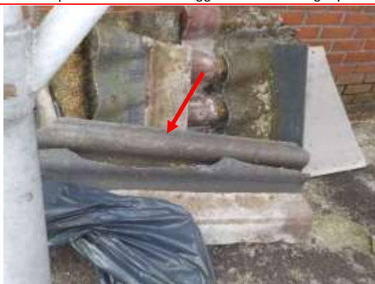
Foto 9 | Foto voor bron Losliggende restanten golfplaat
