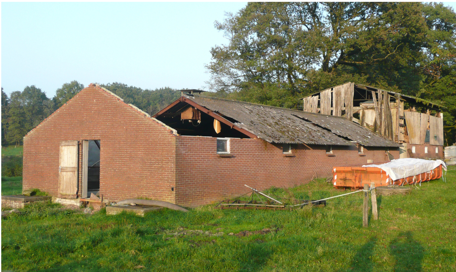
Afbeelding 7. Te slopen landschapsontsierende bebouwing aan Maatmansweg
