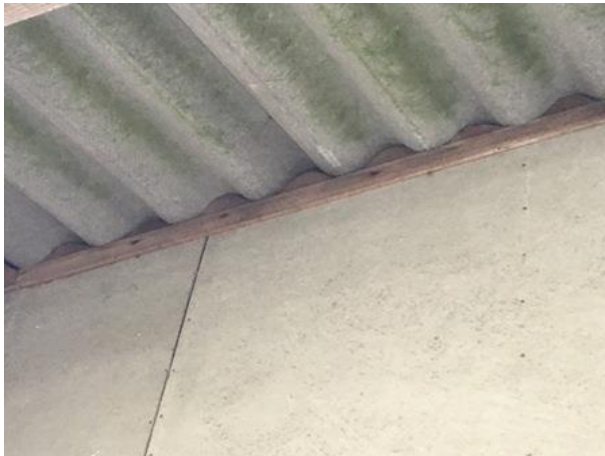
Afgedichte nokken in een golfplaat. Hierdoor kunnen vogels niet in het gebouw nestelen.
