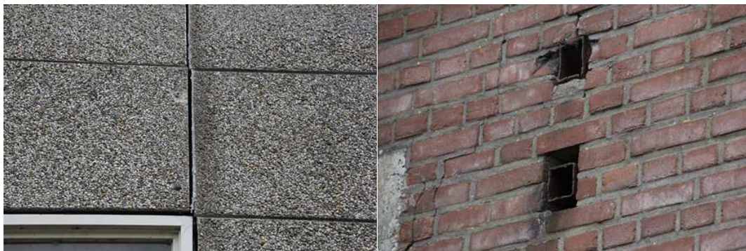
Potentiële invliegopeningen voor vleermuizen. Een open dilatatievoeg (links) en openingen naar een spouw (rechts).
