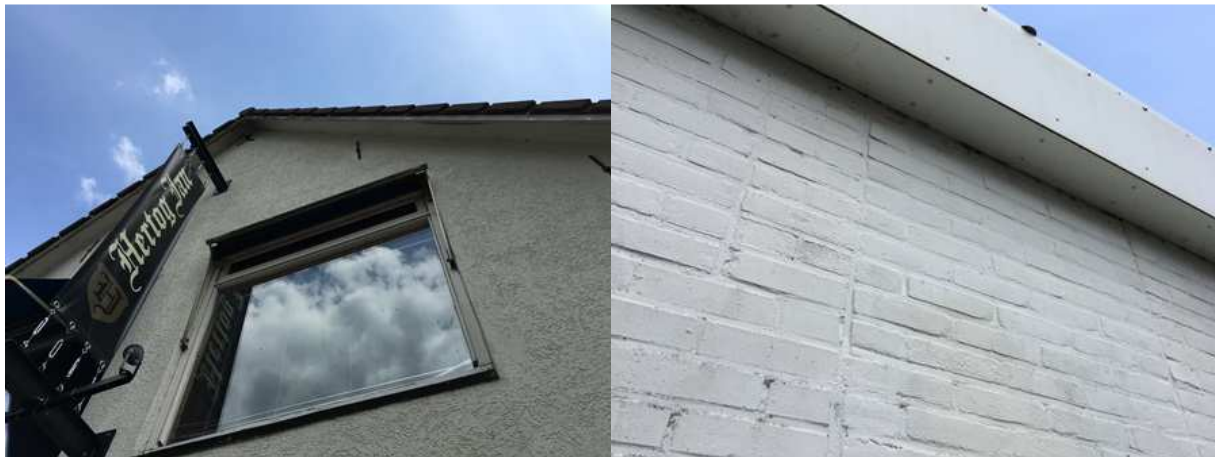
De gevelbetimmering van de bebouwing is overal strak tegen de buitenmuur geplaatst. Hierdoor kunnen vleermuizen de spouw niet bereiken.
