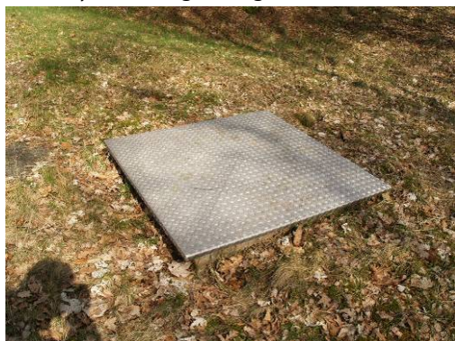
Ondergrondse infra thv bunker S8
