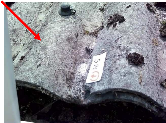
Foto 19 | Golfplaten op het dak
