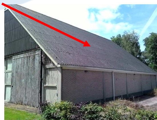
Foto 2 | Golfplaten op het dak
