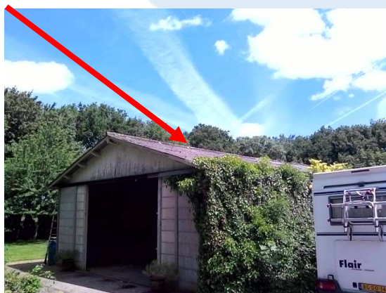
Foto 16 | Golfplaten op het dak
