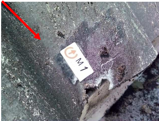
Foto 3 | Golfplaten op het dak
