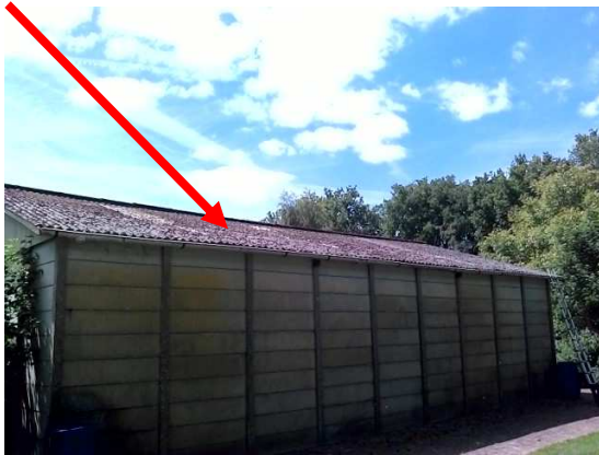
Foto 18 | Golfplaten op het dak
