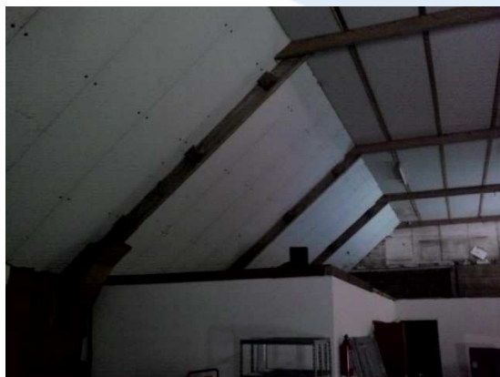
Foto 1 | Golfplaten op het dak
