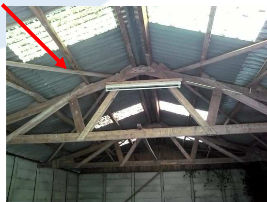
Foto 17 | Golfplaten op het dak
