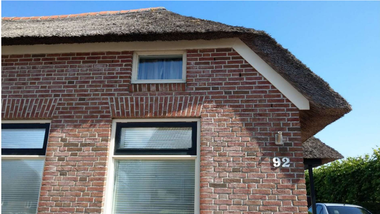
Figuur 3: Voorzijde woonboerderij met potentiële invliegopeningen (open stootvoegen) voor vleermuizen (links en rechts van het kleine raam). Hier kunnen ze de spouwmuur in.
