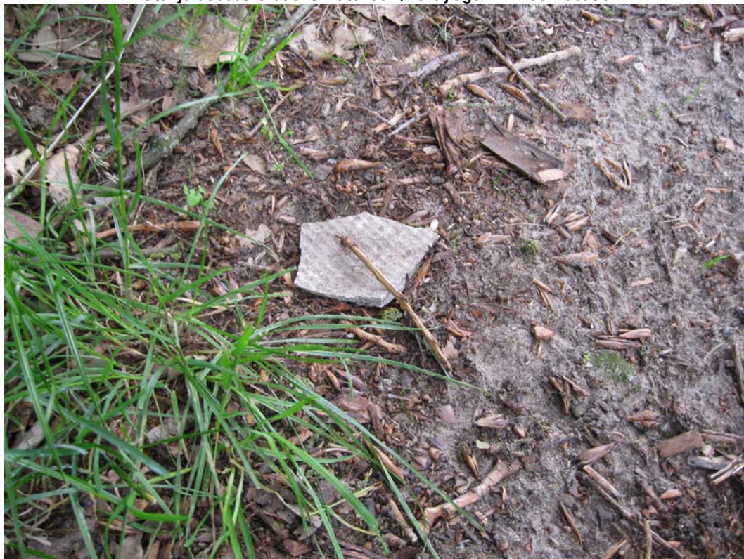
Stukje asbestverdacht materiaal (zie bijlage 1.2 voor locatie)
