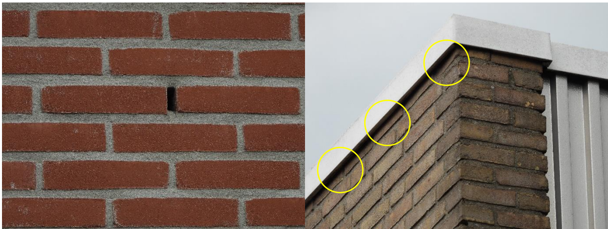
Foto links; openstootvoeg in de buitengevel. Foto rechts; openingen onder de daklijsten (gele cirkels).
