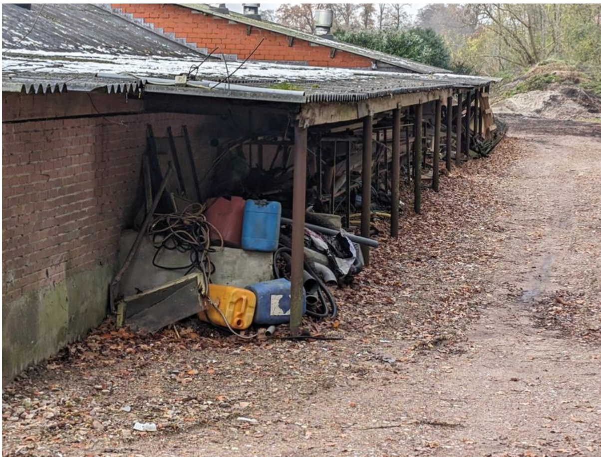
Nr. 1 Alleen overkapping wordt verwijderd
