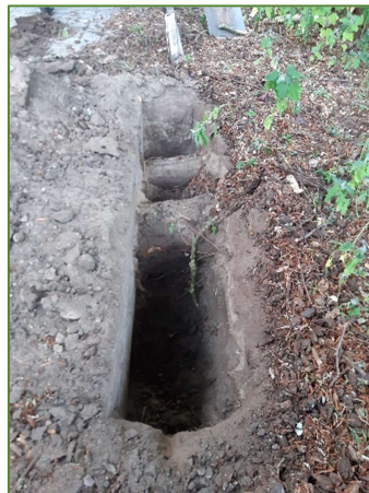
Profielsleuf 1 met enkele dikke wortels die onder de verharding doorgroeien.
