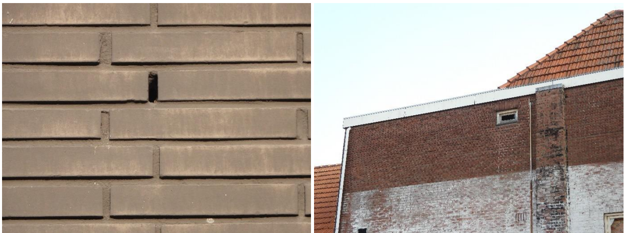
Foto links: open stootvoegen vormen een potentiële invliegopening voor vleermuizen om een verblijfplaats te bezetten in de luchtsponw. Foto rechts: de holle ruimte tussen de gevel en de boeiboord vormt een potentiële verblijfplaats voor vleermuizen.
