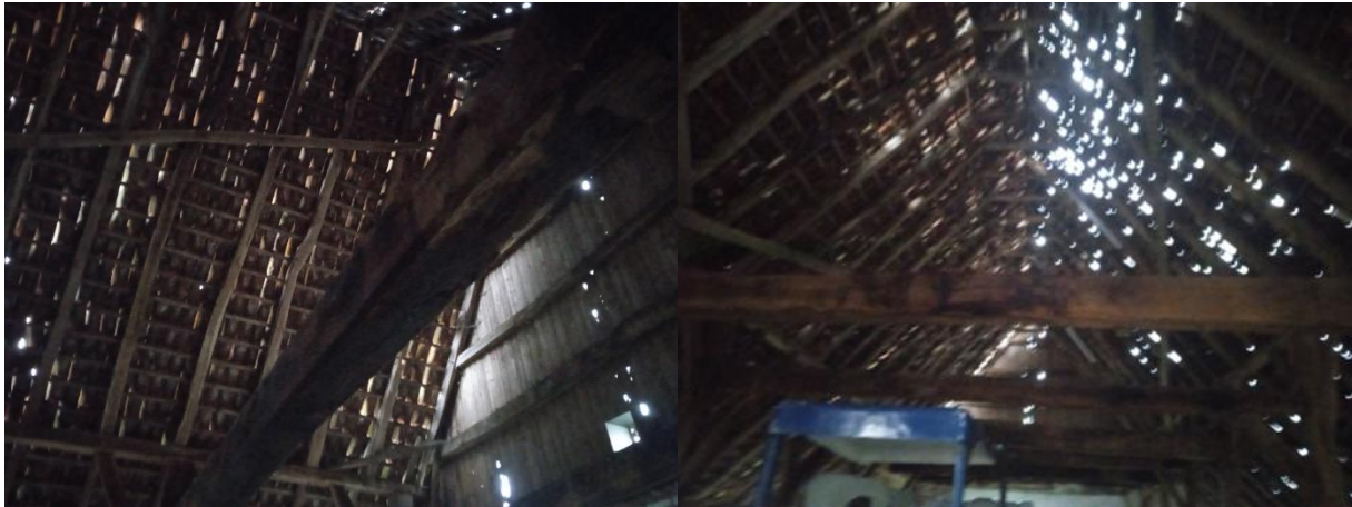
De schuur beschikt niet over dakbeschoot/dakisolatie waardoor het dakvlak geen nestplaats vormt voor huismus.
