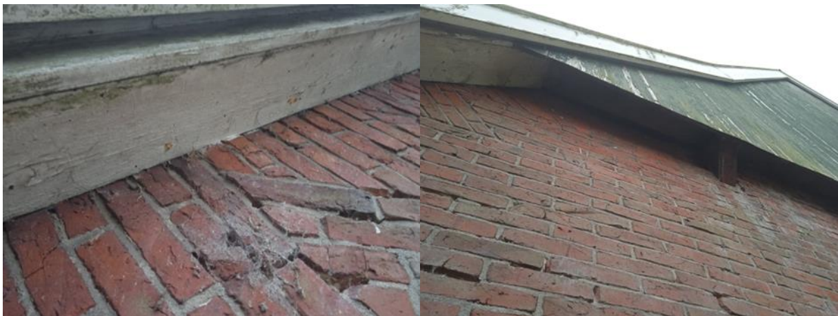
Foto links; De betimmering van het dakoverstek sluit naadloos aan op de buitengevels. Foto rechts; De ruimte tussen de topgevel en de buitengevel is te groot.
