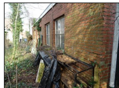
Figuur 5. Rommelhoek aan de westzijde van de onderzoekslocatie, kijkend in noordelijke richting. Links de tuin van de naastgelegen woning.
