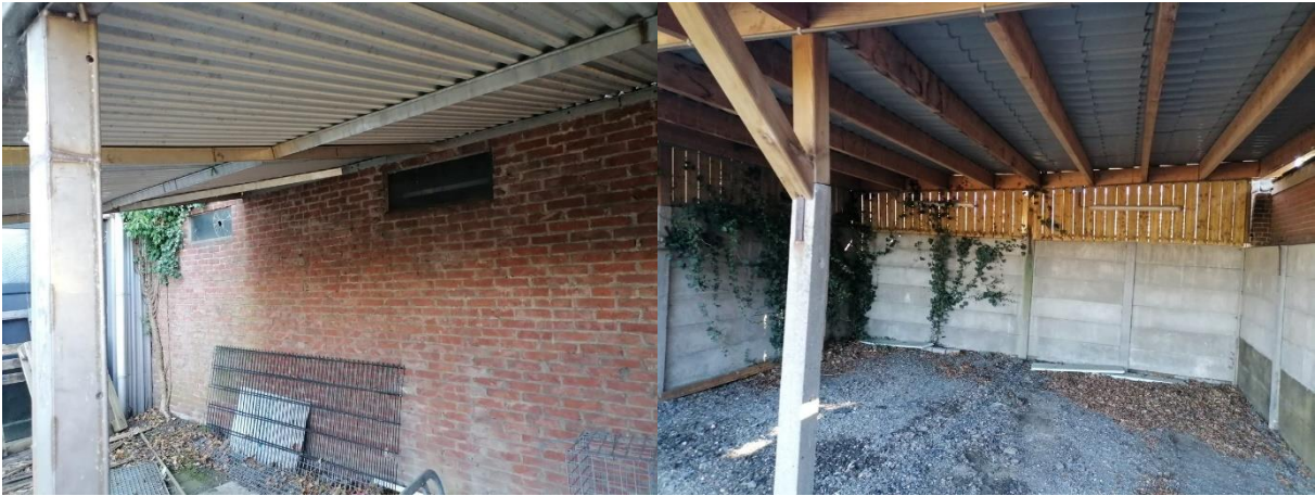
De onderliggende balken sluiten te strak aan op de daken van de overkappingen waardoor er geen nestplaats voor vogels ontstaat.
