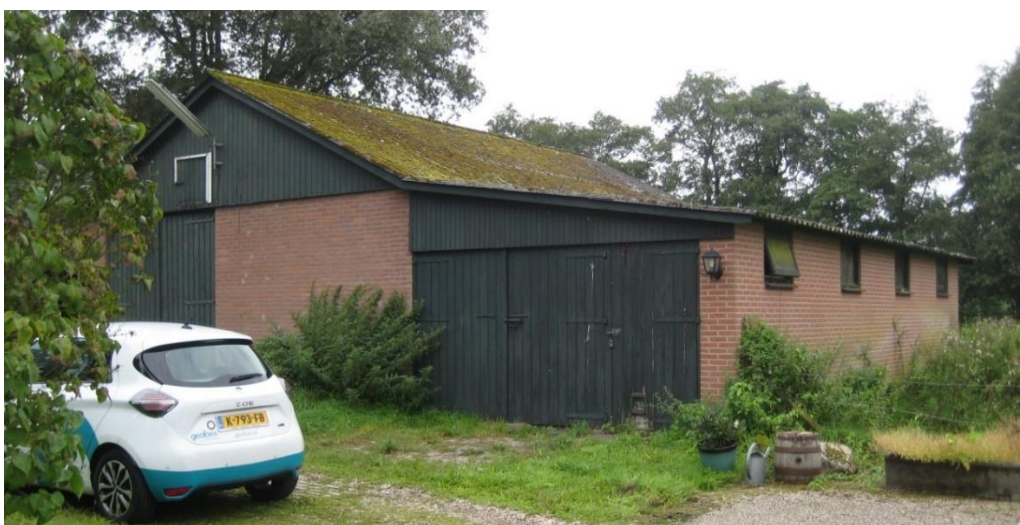
Afbeelding 2.4: Asbestverdacht dak op schuur en druppelzone (bron: terreinverkenning d.d. 30 augustus 2023)
