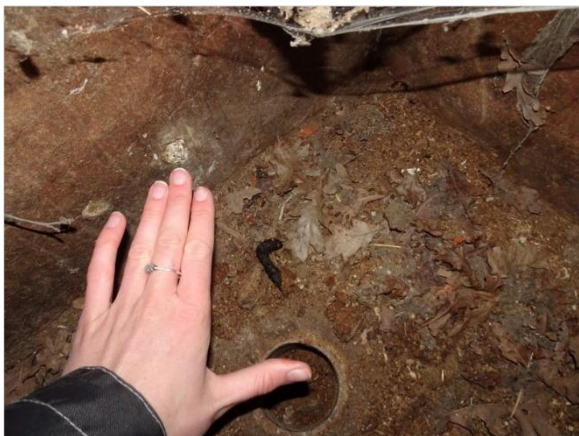
Figuur 5.12 Uitwerpselen, aangetroffen in gebouw 4.
