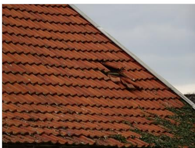
Figuur 5.9 Ruimte tussen de dakpannen van gebouw 4.
