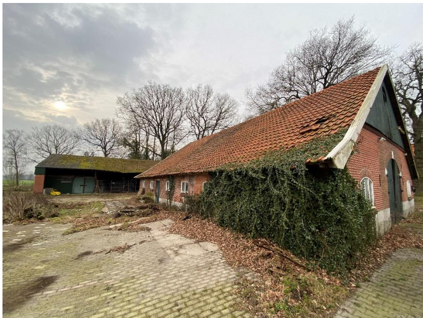
De rechter zijgevel vanaf de straat gezien is deels aan het zicht onttrokken door begroeiing.
