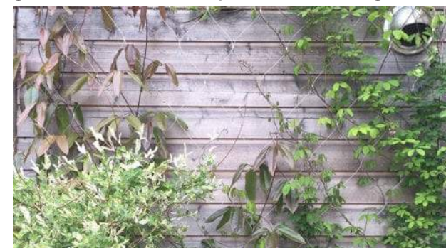
hulpconstructie tbv klimplanten
