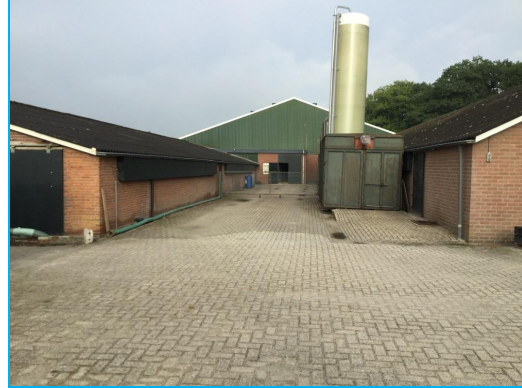
Foto 2: locatiefoto met asbestdak en dakgoot
