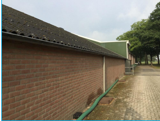
Foto 1: locatiefoto met asbestdak en dakgoot
