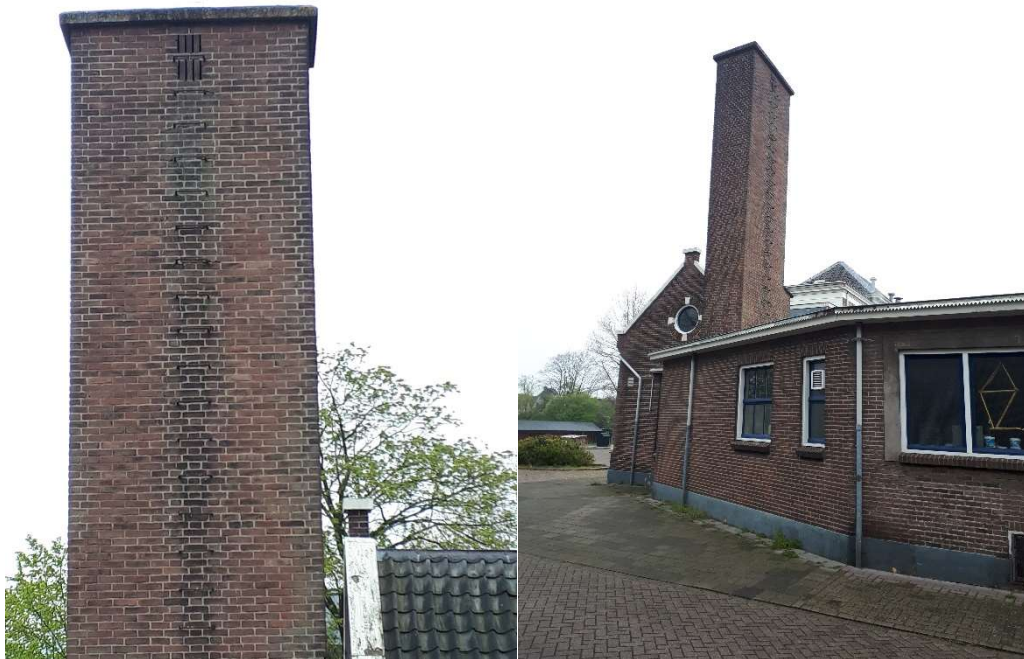
Figuur 4.5 De schoorsteen met ventilatievoegen waar een zomerverblijf van gewone dwergvleermuis in is aangetroffen.
