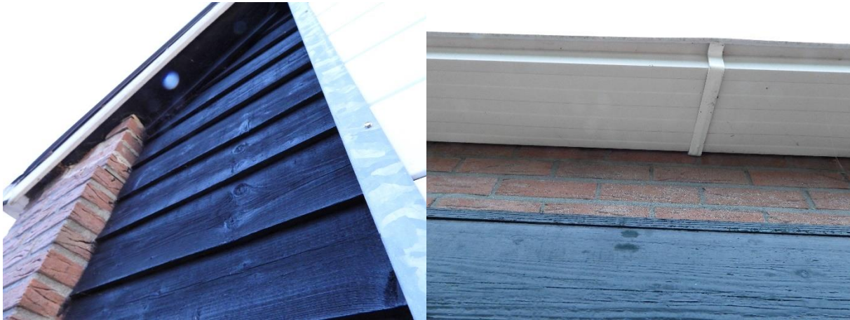
Foto links; de planken sluiten strak op elkaar aan. Foto rechts; de betimmering van het dak overstek sluit naadloos aan op de buitengevels.
