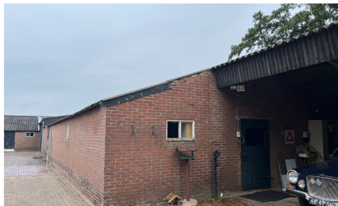
Afbeelding 4. Aanpalende schuur (amoveren)
