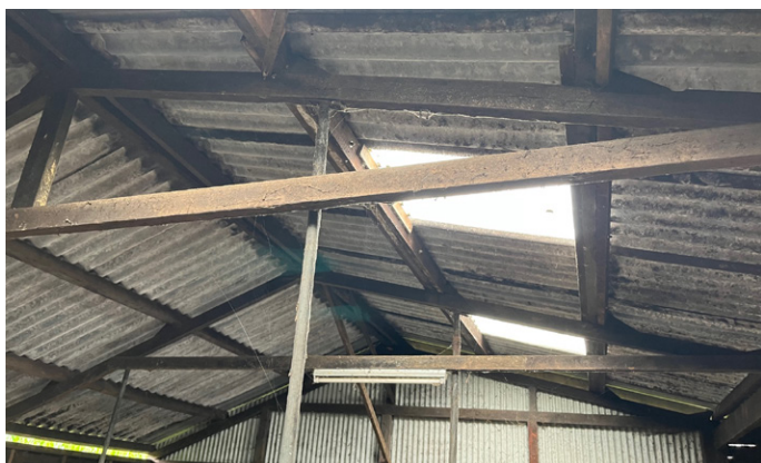
Afbeelding 5. Geen isolatie aanpalende schuur met ontbrekende dakdelen
