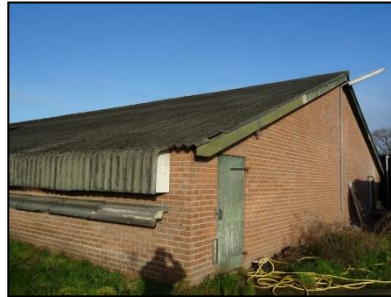
Figuur 13. Overhangende dakplaten oostelijke stal.
