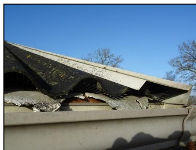
Figuur 10. Loslatende vogelschroot onder dakplaten westelijke stal.
