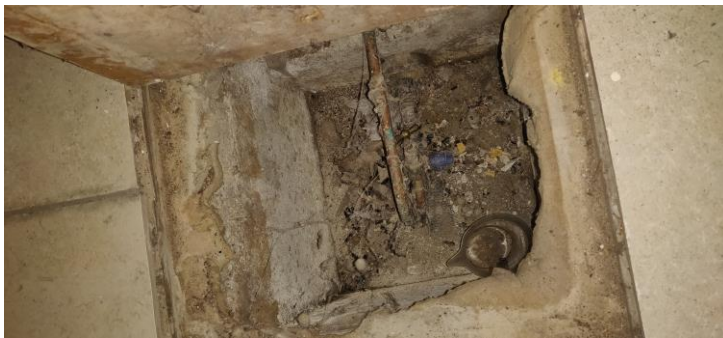
(water afsluiter bij de achterdeur)
