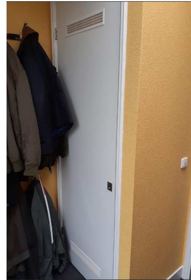
Ventilatie rooster meterkast nr 12
