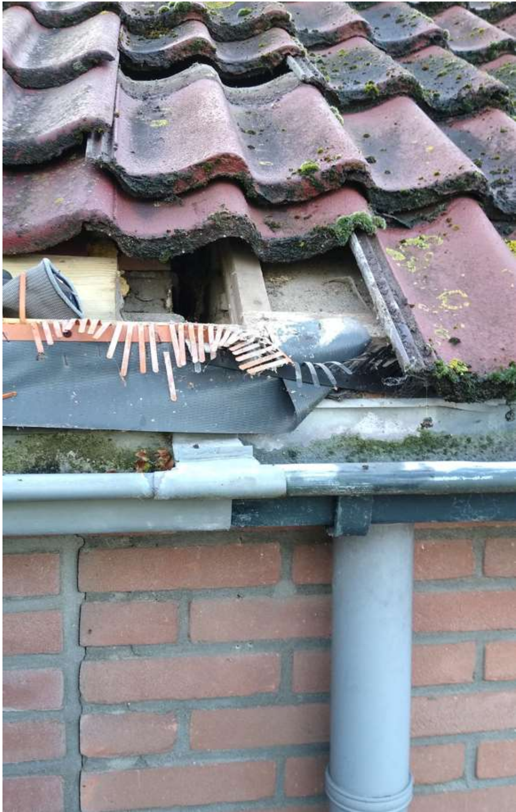
Ter plaatse van de woningscheidende wand is de dakplaat incl. bovenliggende panlat onderbroken, zie bovenstaande foto.
