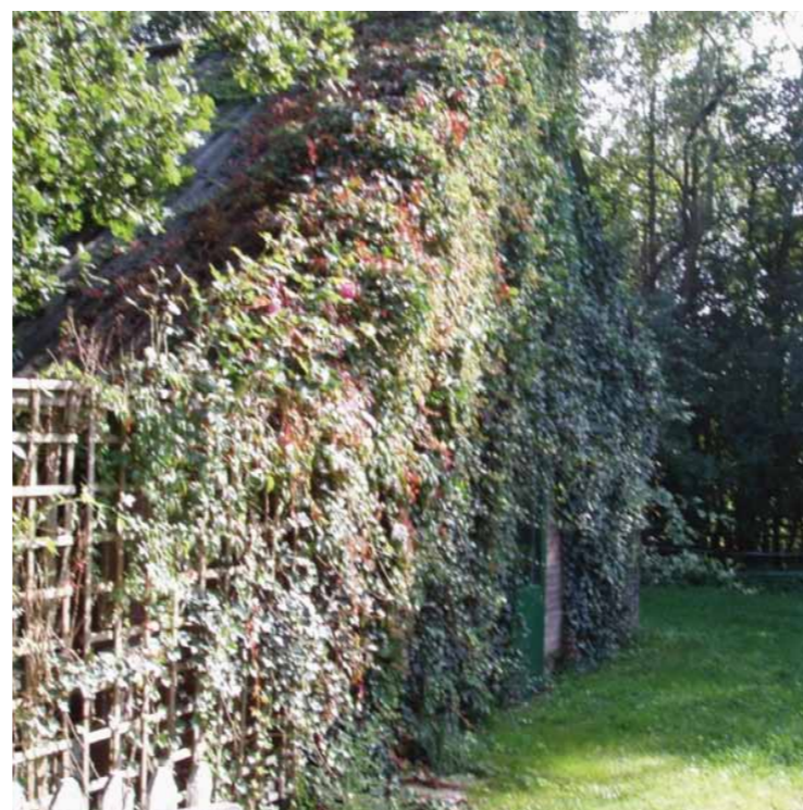
Impressie achterstallig onderhoud bij aankoop erf (bron: C. Van Lohuizen)
