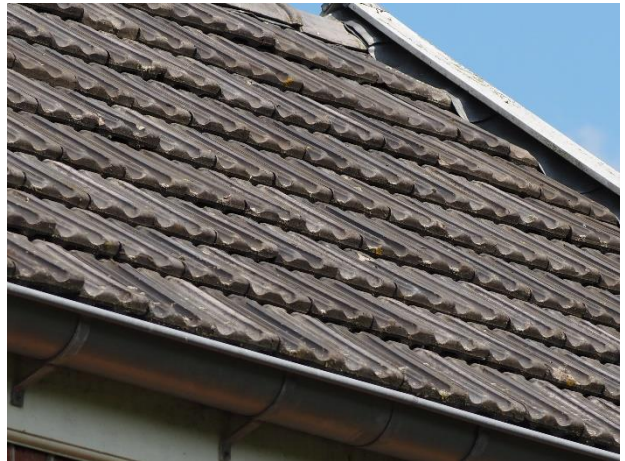
Figuur 8: Detail foto 1 dakpannen voorste gebouw
