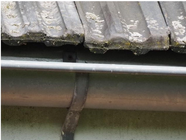
Figuur 5: Detail foto 2 dakpannen, de dakpannen zijn volledig afgesloten voor huismussen
