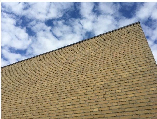
Open stootvoegen aangetroffen in de gevels van de bebouwing.
