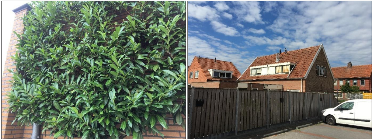
Foto links: potentiële nestlocatie van vogels in de beplanting, foto rechts: potentiële nestlocatie van huismuis onder de dakpannen.
