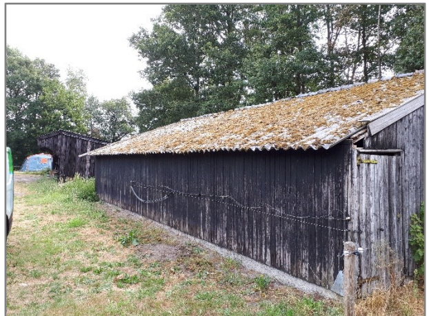
Foto 4: Locatie – schuur met asbestverdacht dak zonder dakgoot (fotorichting 4)
