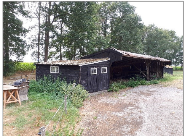
Foto 8: Locatie – schuur met asbestverdacht dak zonder dakgoot (fotorichting 8)
