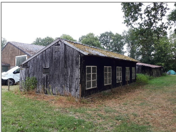
Foto 5: Locatie – schuur met asbestverdacht dak zonder dakgoot (fotorichting 5)
