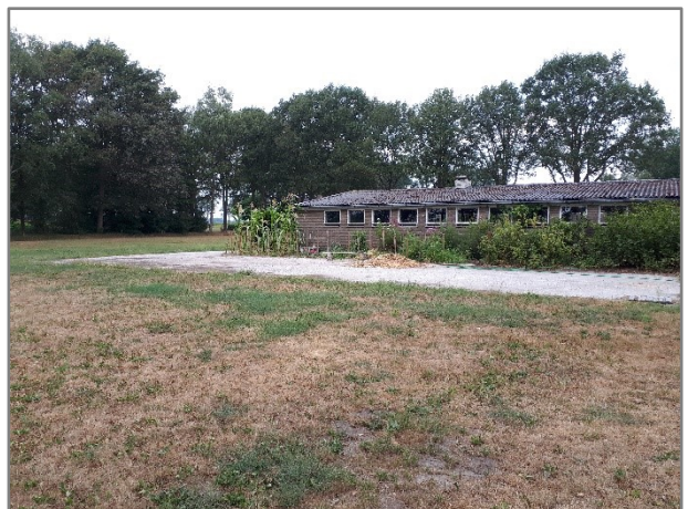
Foto 6: Locatie – stal met asbestverdacht dak met dakgoot (fotorichting 6)
