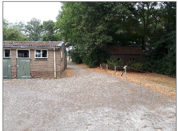
Foto 10: Locatie – garage met asbestverdacht dak (fotorichting 10)
