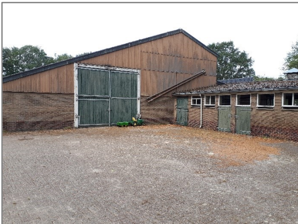
Foto 9: Locatie – schuur met asbestverdacht materiaal aan de gevel (fotorichting 9)
