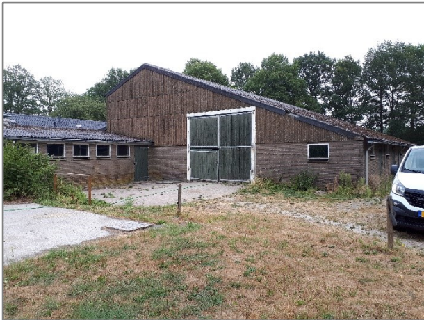
Foto 7: Locatie – schuur met asbestverdacht materiaal aan de gevel en asbestverdacht dak met dakgoot (fotorichting 7)
