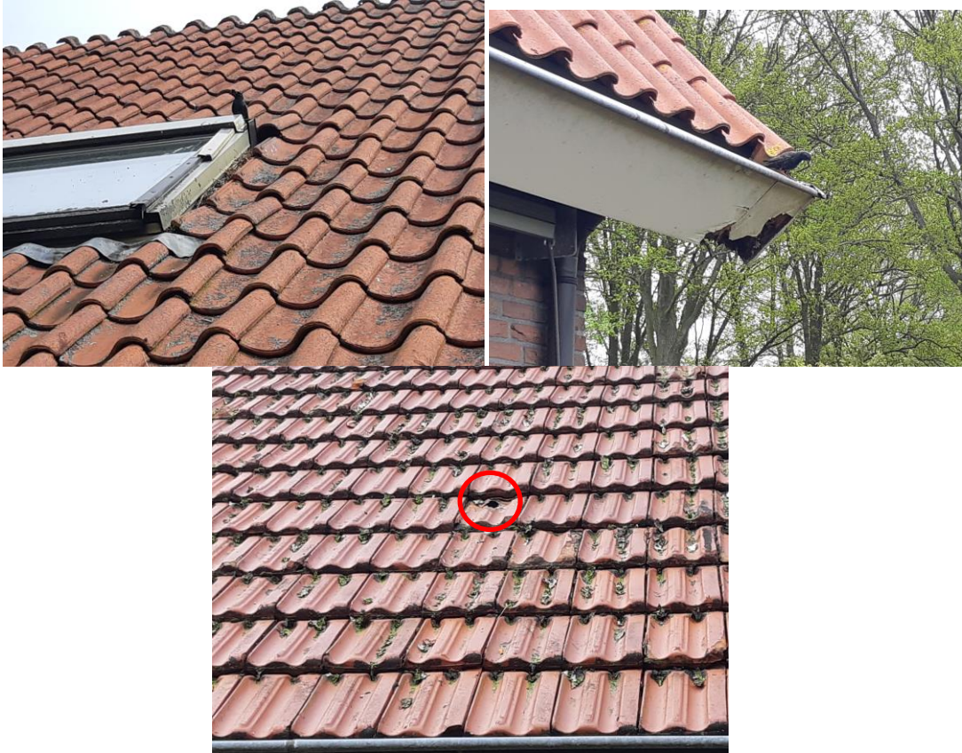
Figuur 3.5 Enkele aangetroffen locaties met spreuwenest. Links- en rechtsboven onder het dak bij de Westermaatweg 2b (erf 1). Onder: Onder het dak via een kapotte dakpan (rood omcirkeld) van de schuur bij de Westermaatweg 4 (erf 2).
