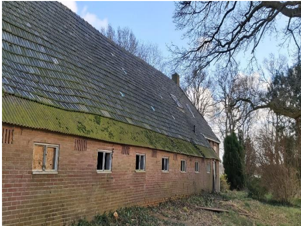
Ventilatieopeningen in de zijgevel (stal) van het gebouw.
