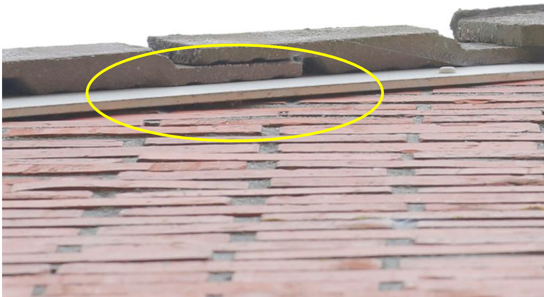
Foto 3 Ruimte tussen boeidelen en gevel.
