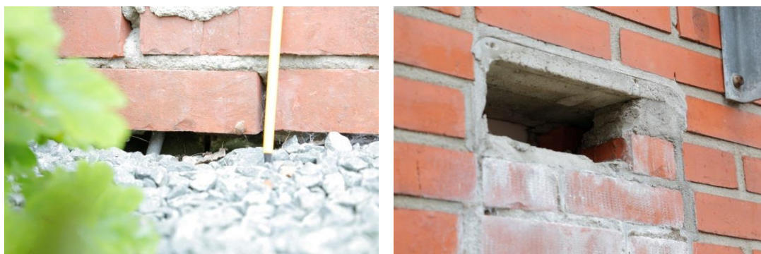
Foto 5 Openingen in de gevelmuur en ontbrekend rooster
