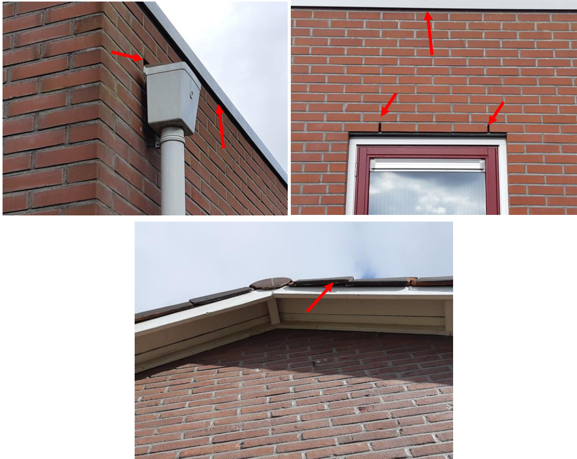
Figuur 3.1 Potentiële invliegopeningen (rode pijlen) die toegang geven tot het dak of de spouwmuur. Linksboven: ruimte bij regenpijp en daktrim. Rechtsboven: open stootvoegen en daktrim. Onder: ruimte bij kantpannen. Bron foto's: Ecogroen
