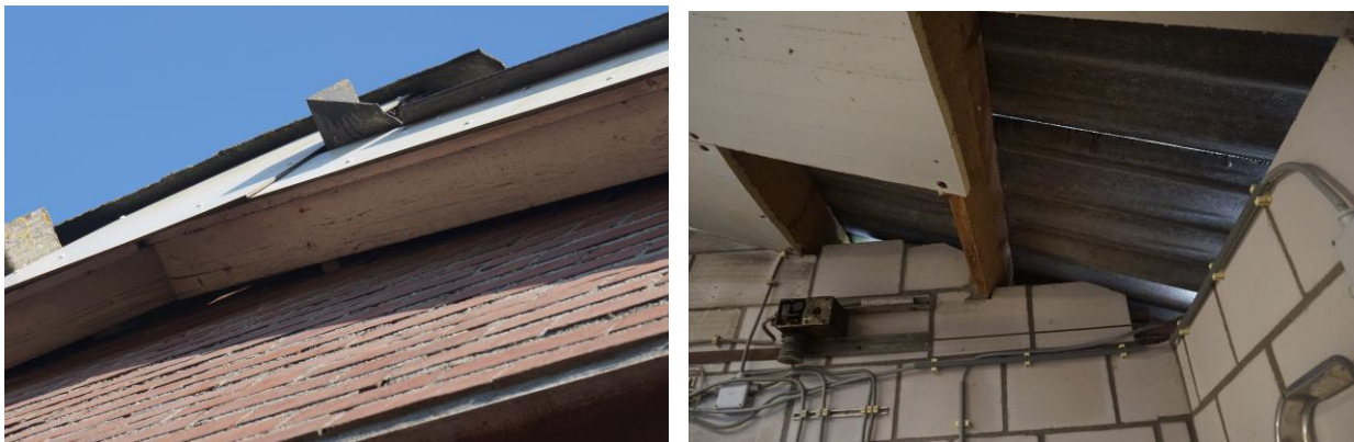
Figuur 5.1. Ruimte tussen de muur en het overstek en tochtige omstandigheden.
