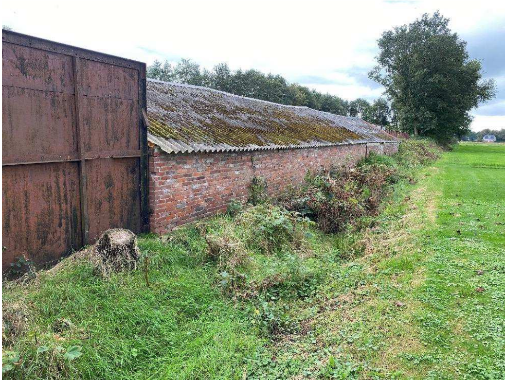
Foto 3. Hertenbaan 21, Erica (asbestverdacht dak aangrenzend perceel)
