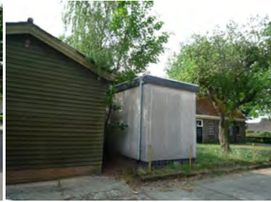
trafo bij Markeweg 3
