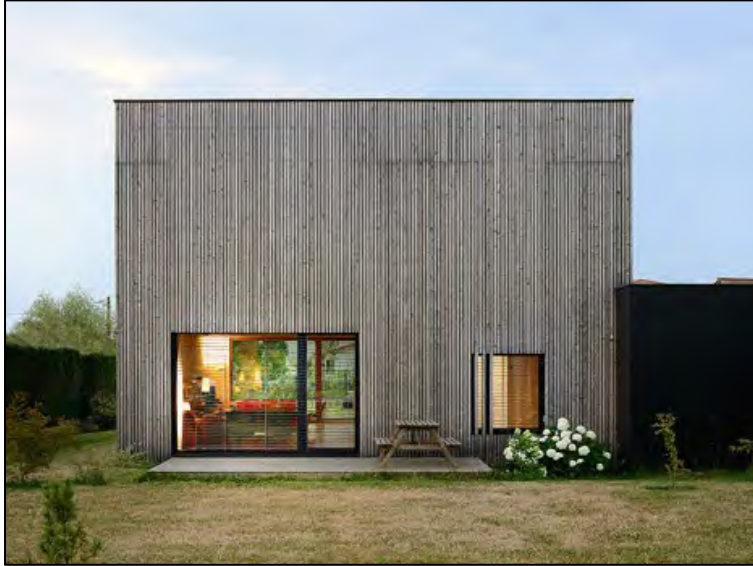
Figuur 62 Vergrijsde houten gevel
