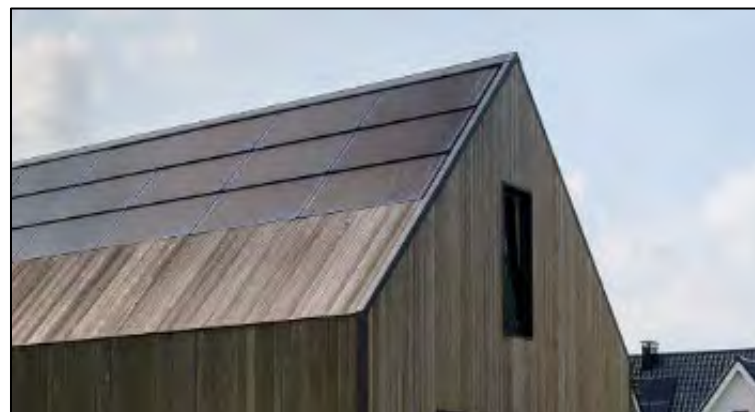
Figuur 57 Op schuine daken zijn zonnepanelen integraal onderdeel van het dakontwerp
